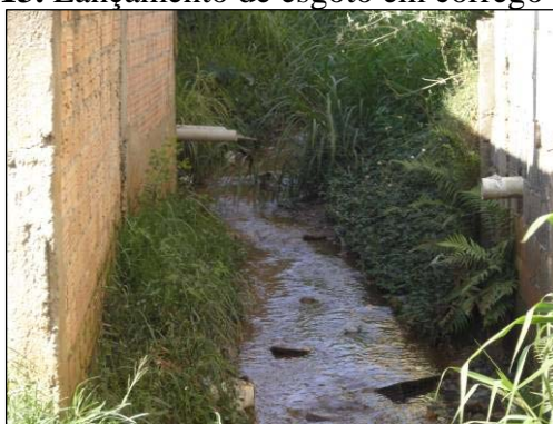
Figura 13. Lançamento de esgoto em córrego direto das residências.
