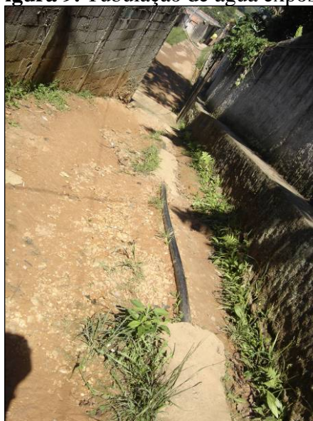
Figura 9. Tubulação de água exposta.
