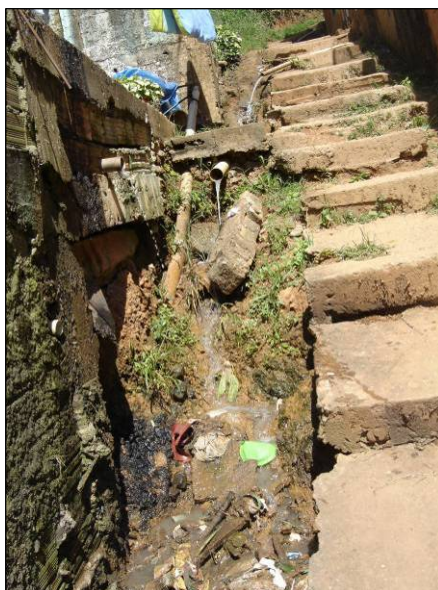
Figura 15. Lançamento de esgoto a céu aberto em local de acesso da população.
