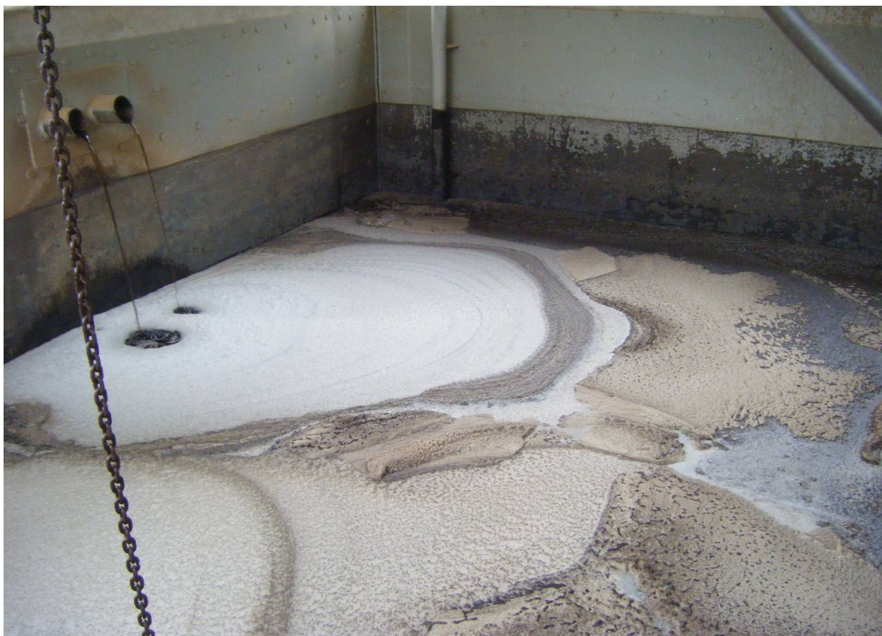
Foto 13 – Chorume dentro do Reservatório – Tanque 2. Fonte: Arantes, F., 2008.
