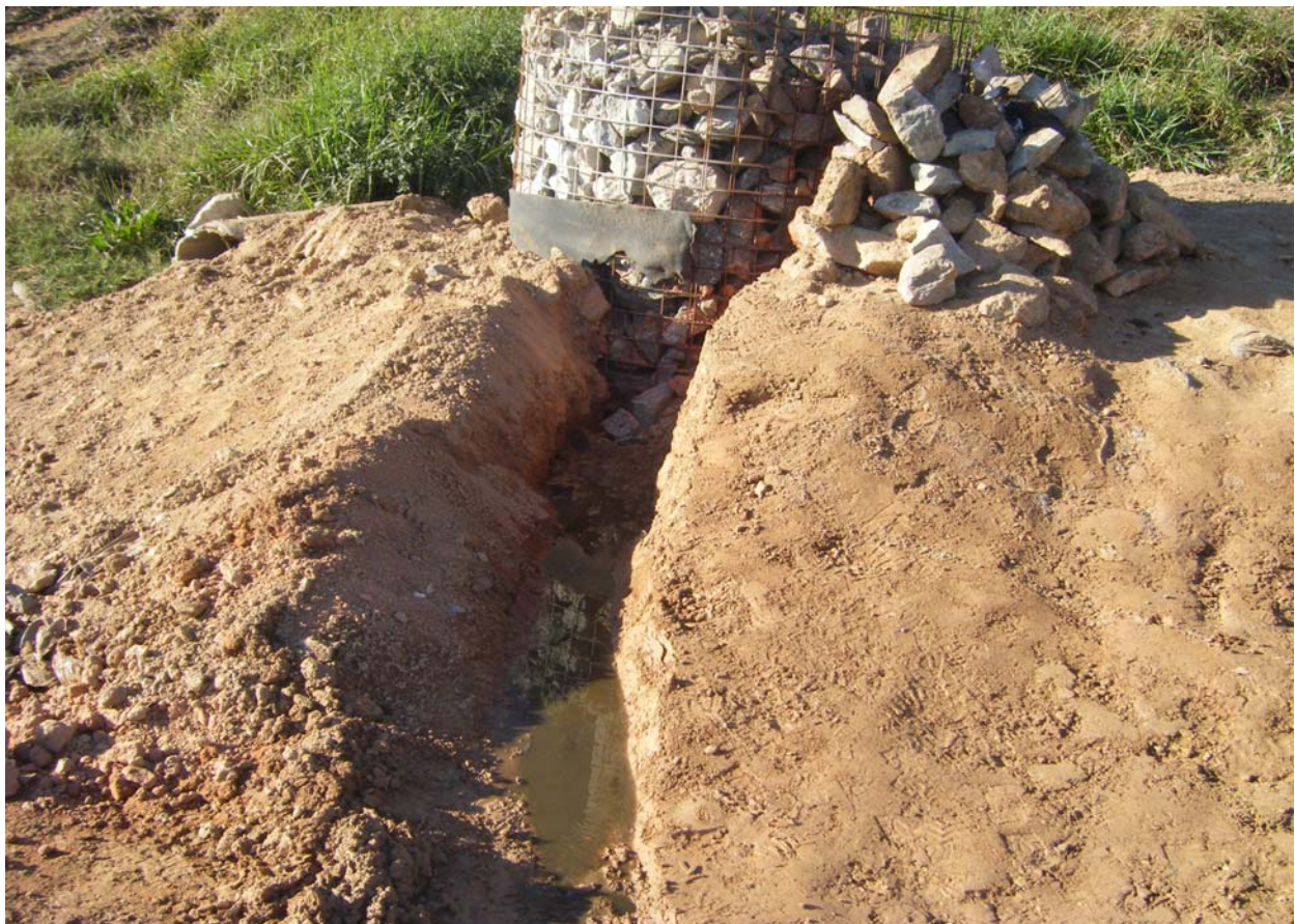
Foto 15 – Material líquido concentrado ao lado da chaminé. Org: Arantes, F., 2008.
