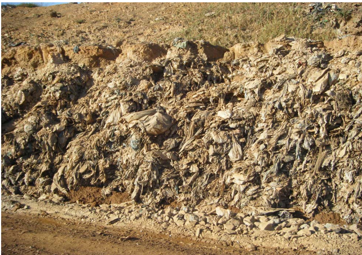
Foto 19 – Erosão no terreno do aterro e a massa do lixo exposta. Fonte: Arantes, F., 2008.
