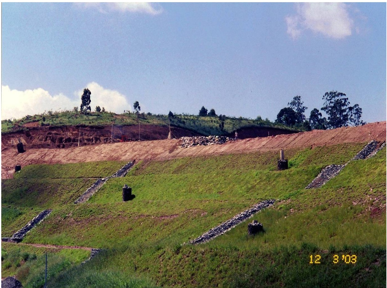
Foto 9 – Sistemas de drenagem das águas pluviais e de queima dos gases produzidos. Fonte: Arantes, F., 2003.
