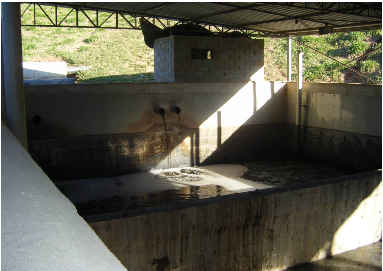
Foto 12 – Reservatório de chorume – Tanque 1. Fonte: Arantes, F., 2008.
